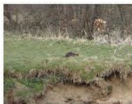
Dégâts sur berge
